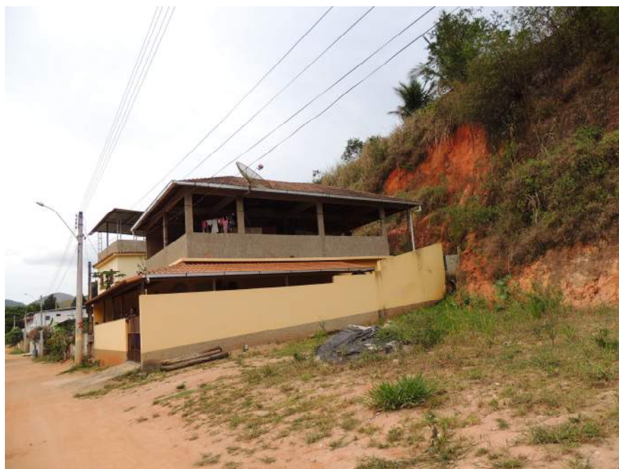
Foto 35 – Talude instável com indícios de movimentos de massa.
