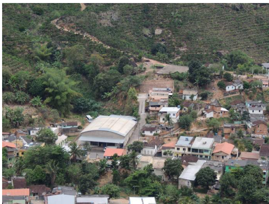
Foto 27 – Talude de corte com altura superior a 8,0m nos fundos do galpão.
