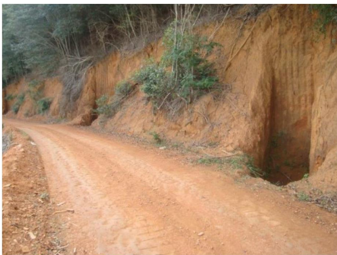
Figura 11-3 – Exemplo de caixa seca implantada em estrada vicinal.
