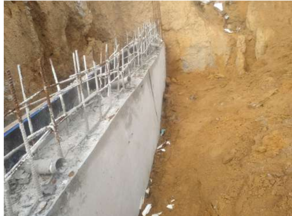
Concretagem mal executada
