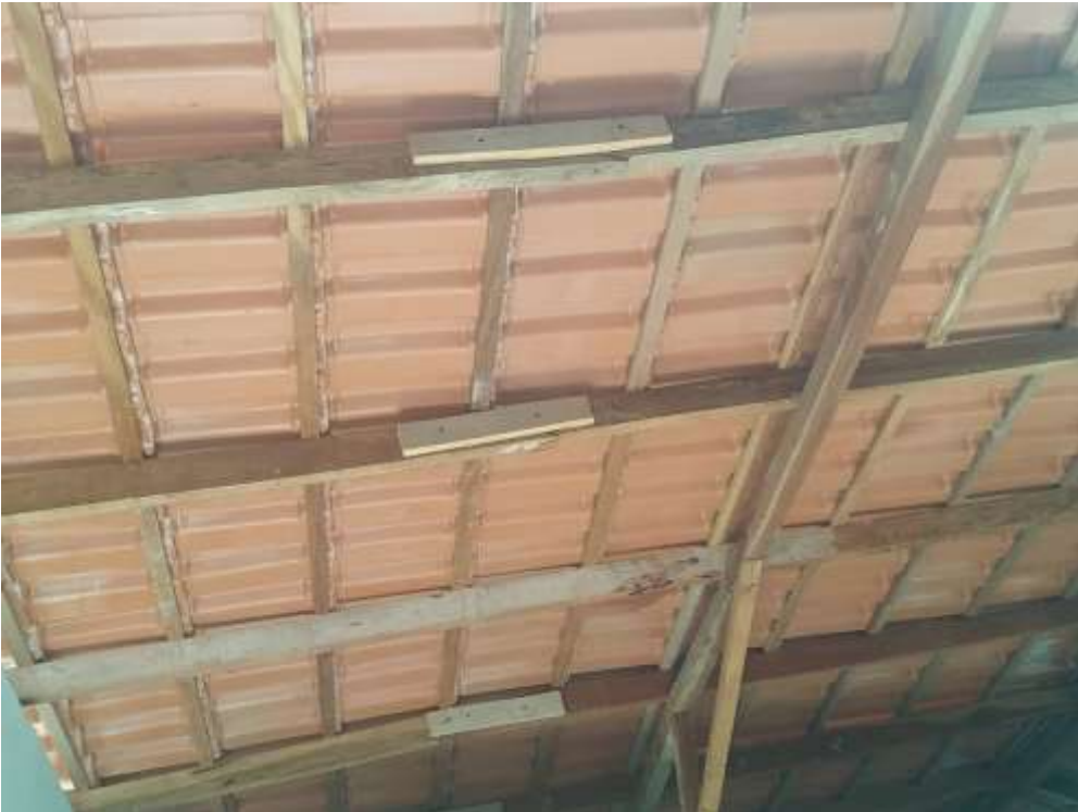
Utilização de material inadequado
