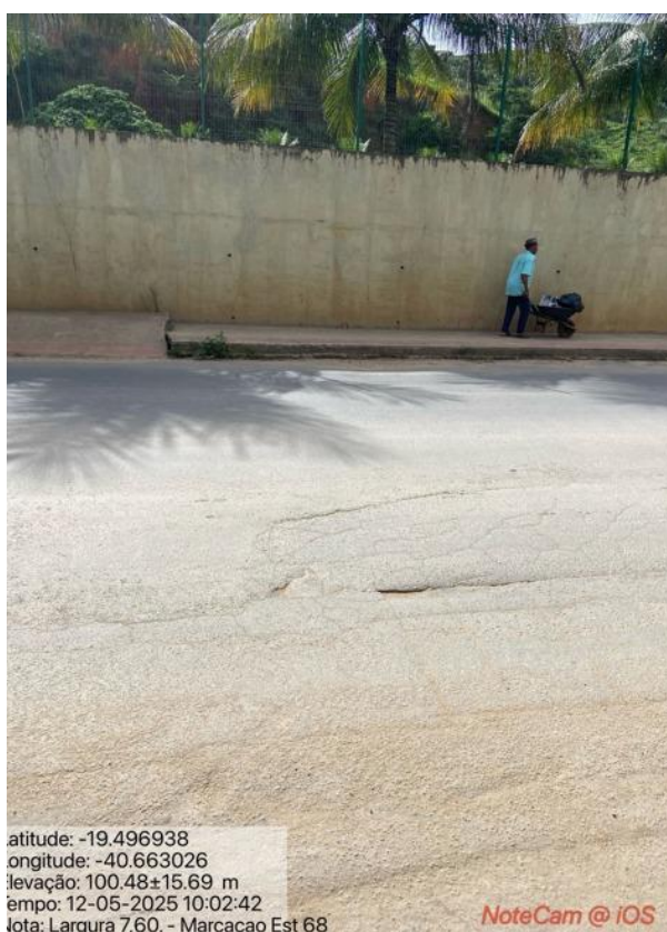
Figura 08 – Registro de patologias na Rod. Gether Lopes de Farias
