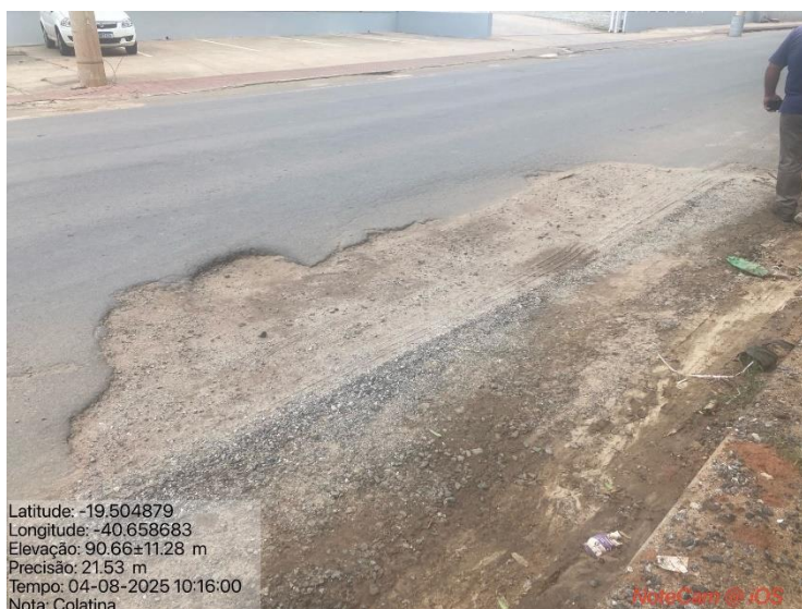
Figura 07 – Registro de patologias na Rod. Gether Lopes de Farias
