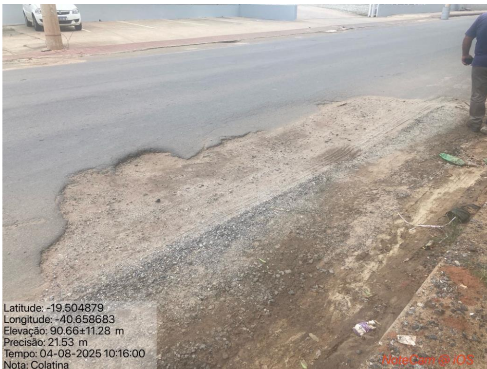
Figura 05 – Registro de patologias na Rod. Gether Lopes de Farias
