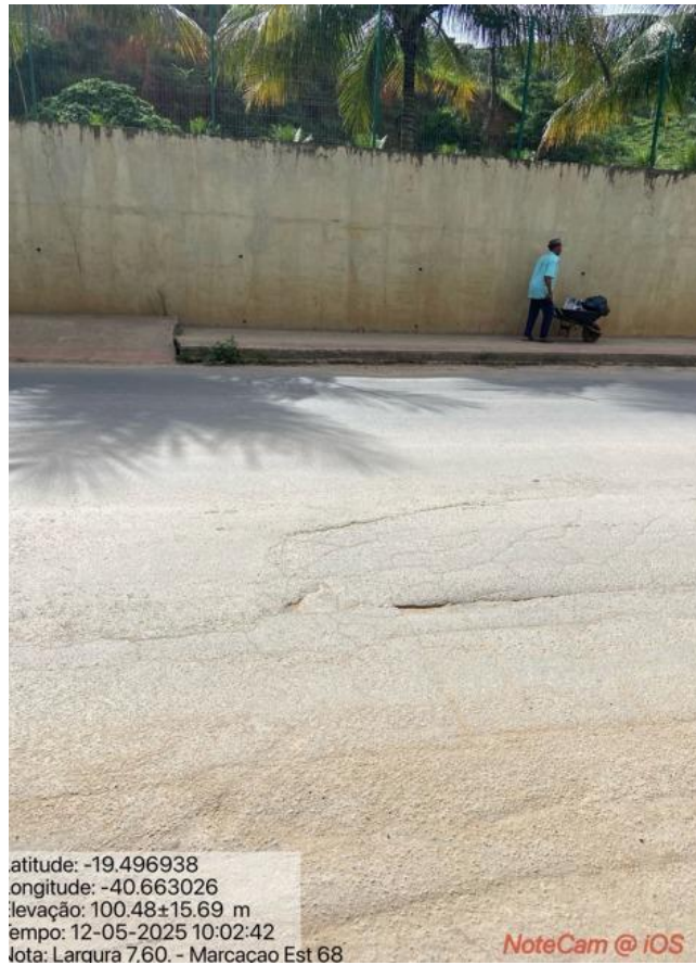
Figura 06 – Registro de patologias na Rod. Gether Lopes de Farias
