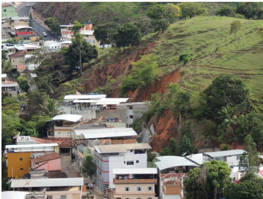
Foto 8 - Vista de montante para jusante do setor de risco com detalhe para os taludes de corte gerados com angulações inadequadas e instáveis.
