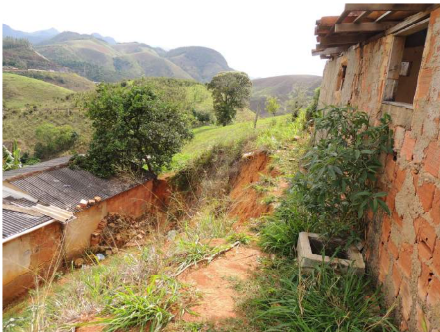
Foto 17 - Vista dos fundos do setor de risco com detalhe para o baixo padrão construtivo e o talude de corte não estabilizado.
