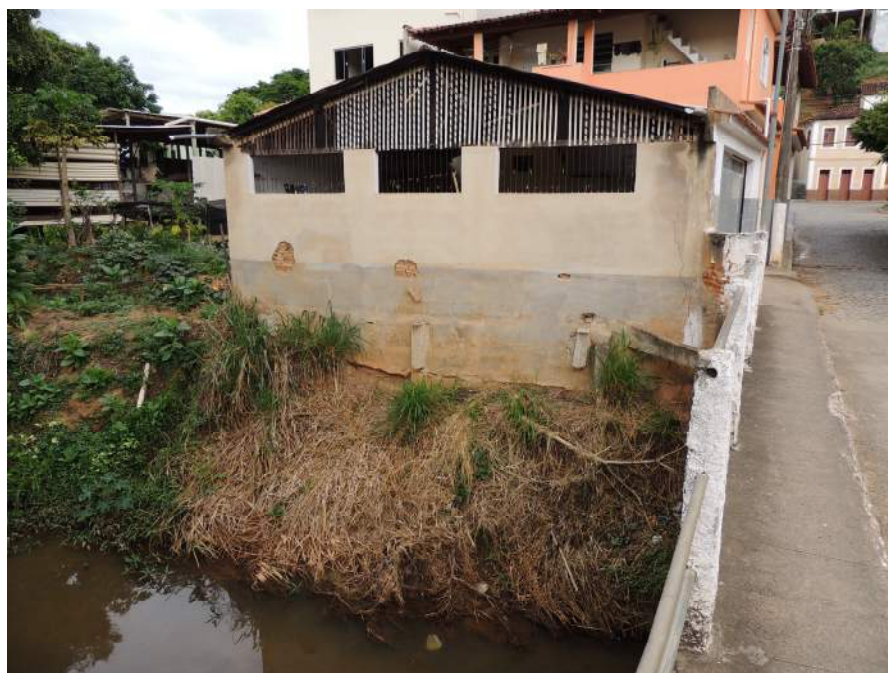
Foto 3 – Vista frontal do domicílio com detalhe para a proximidade em relação a canal.
