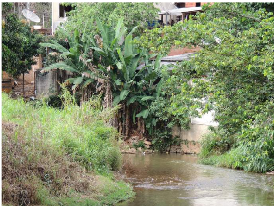
Foto 12 – Aproximação em relação ao trecho com suscetibilidade a solapamentos com descalçamento das fundações dos domicílios.
