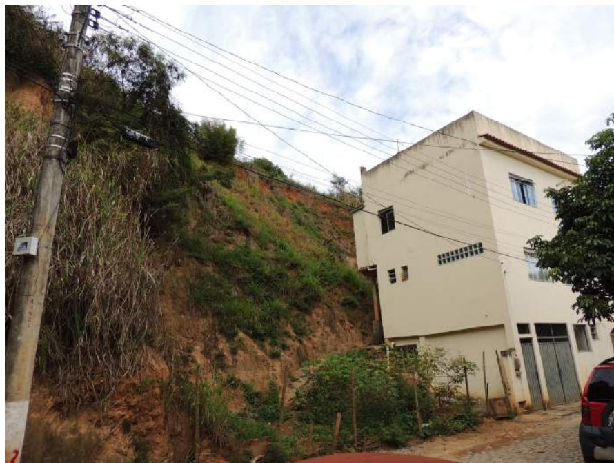
Foto 9 – Vista da base do setor de risco com detalhe para encosta inclinada.
