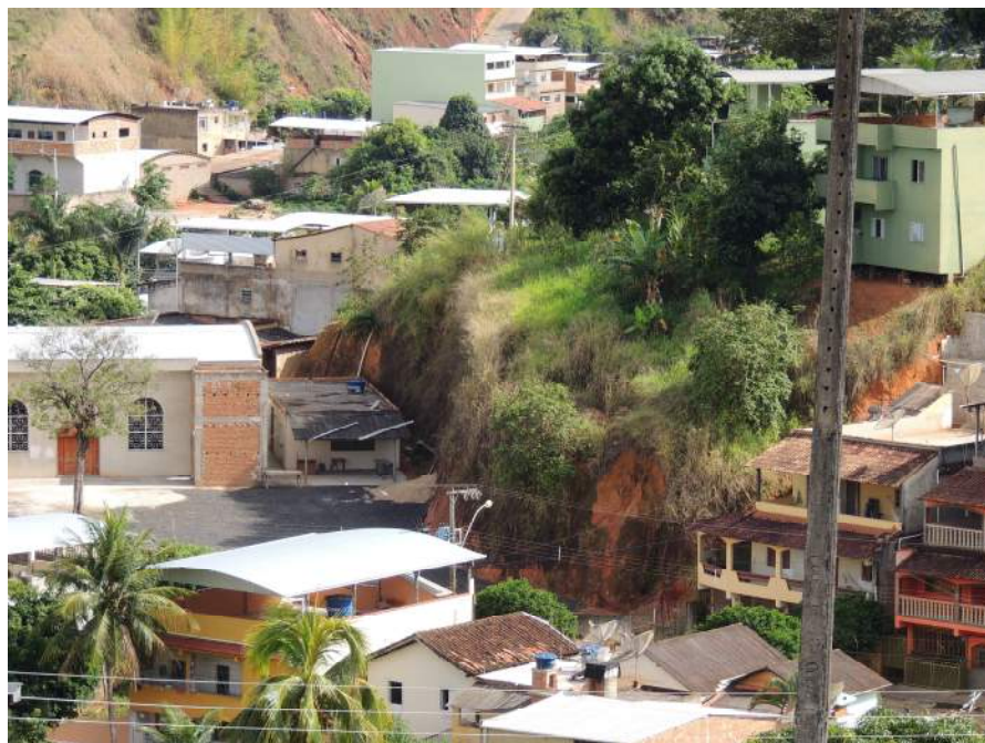
Foto 62 – Detalhe do mesmo local para visualização do afastamento da edificação em relação ao talude.
