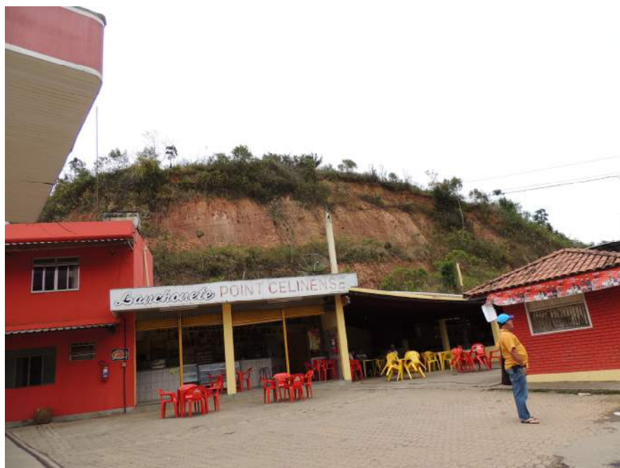
Foto 71 – Distrito/Bairro de celina com detalhe para talude de corte instável ao longo da rua do posto de gasolina.
