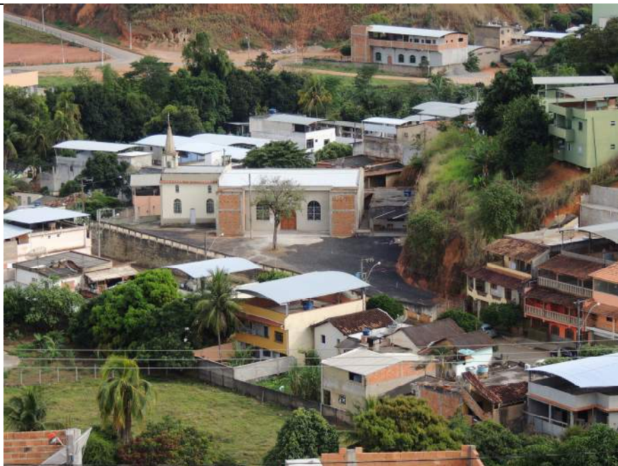
Foto 61 – Talude de corte vertical e construção sem afastamento ou estabilização adequada, ao lado da Igreja.
