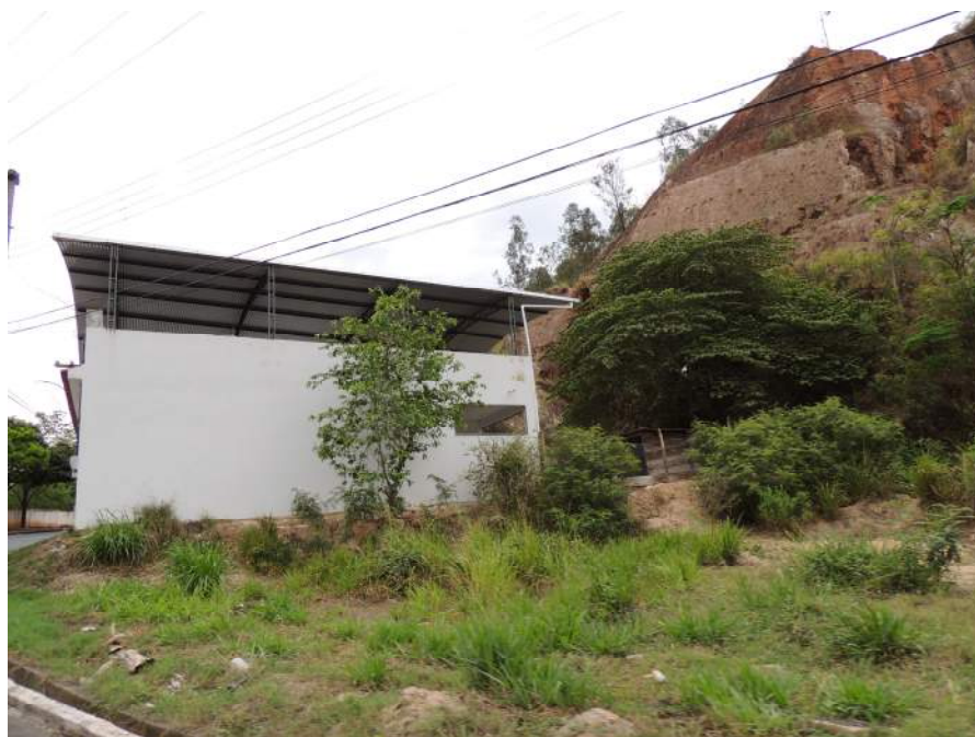
Foto 59 – Trecho com indícios de movimentação e instabilidade as margens da BR 482 próximo ao local onde foi executada uma obra de estabilização de grande porte.
