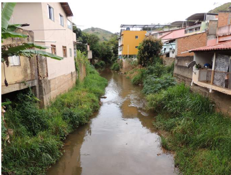
Foto 5 - Detalhe para outro trecho ocupado sobre o canal com indícios de solapamento e descalçamento das fundações.
