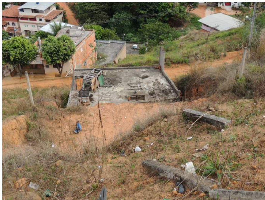
Foto 20 – Domicílio em construção, talude de corte vertical e instável.
