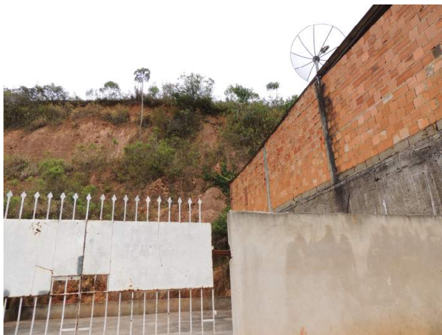
Foto 73 – Detalhe para os indícios de instabilidade ao longo da encosta.
