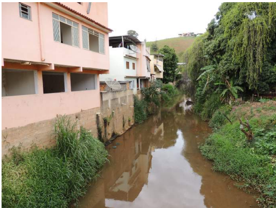
Foto 4 – Detalhe para outro trecho ocupado sobre o canal com indícios de solapamento e descalçamento das fundações.
