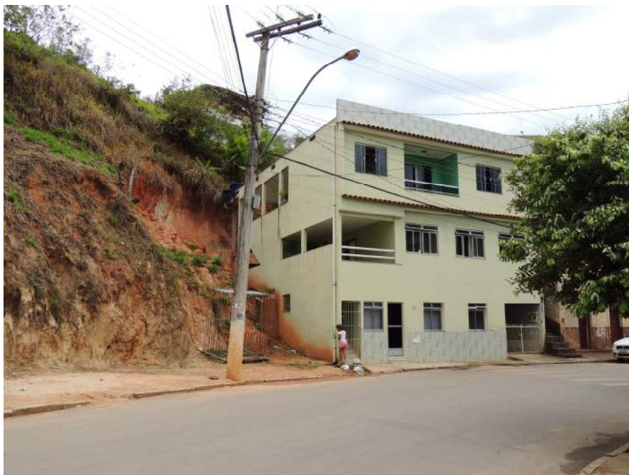
Foto 52 – Vista a partir da base do setor de risco com detalhe para afastamento do prédio em relação ao talude inferior a 1,0m.
