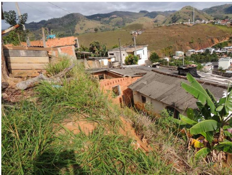
Foto 16 – Vista dos fundos do setor de risco com detalhe para o baixo padrão construtivo e o talude de corte não estabilizado.
