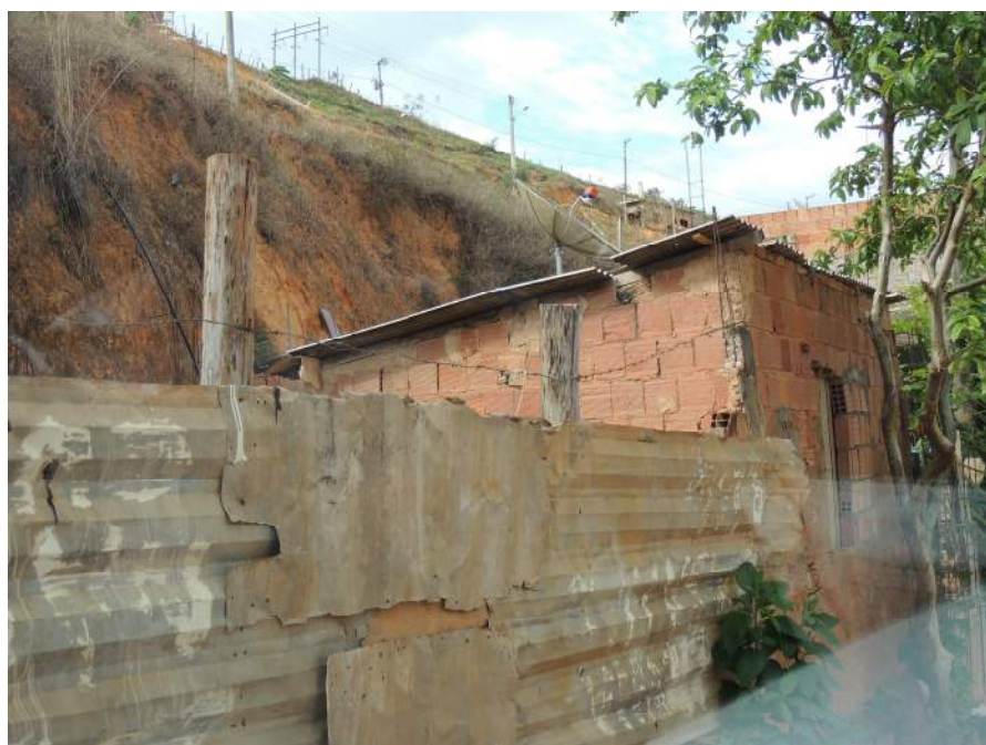
Foto 21 – Domicílios de baixo padrão construtivo e talude de corte vertical e instável nos fundos do domicílio sem afastamento em relação ao mesmo.
