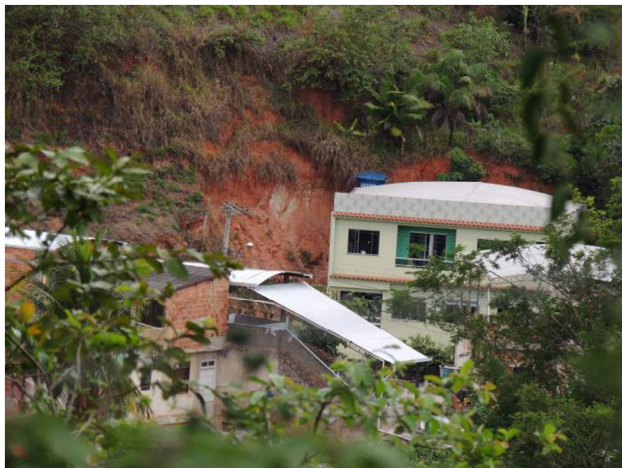
Foto 51 – Detalhe para a geometria do talude de corte e indícios de instabilidade no setor de risco.
