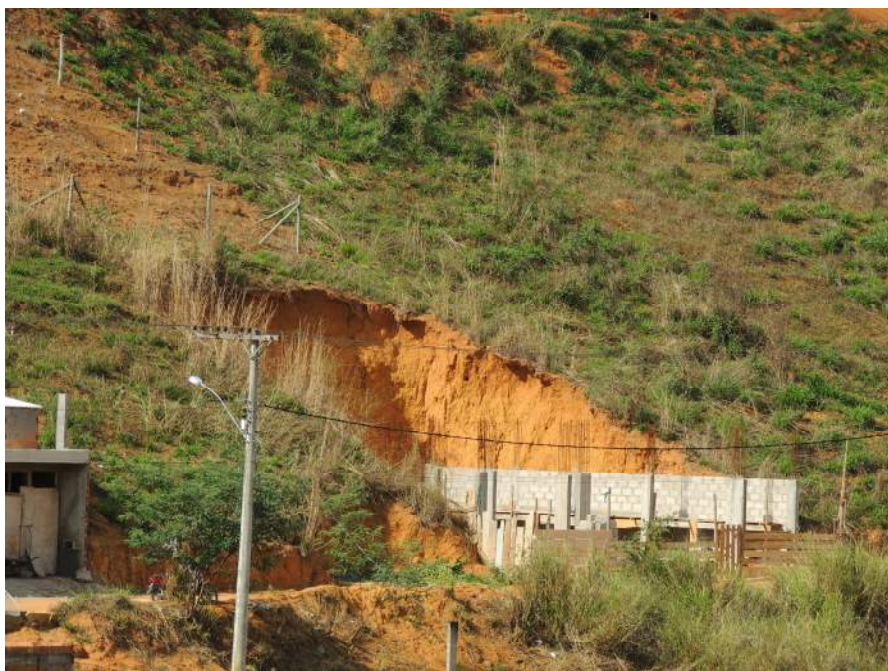
Foto 25 – Detalhe para início de uma nova ocupação sem a preocupação anterior de estabilizar os taludes de corte instáveis.
