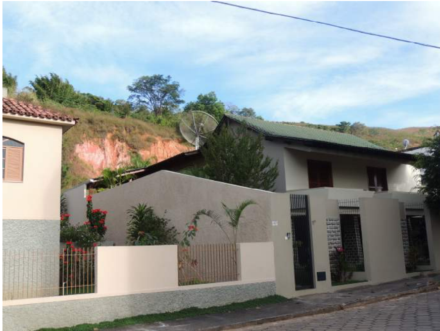
Foto 12 - Vista a partir da base do setor com detalhe para os indícios de instabilidade ao longo da encosta.
