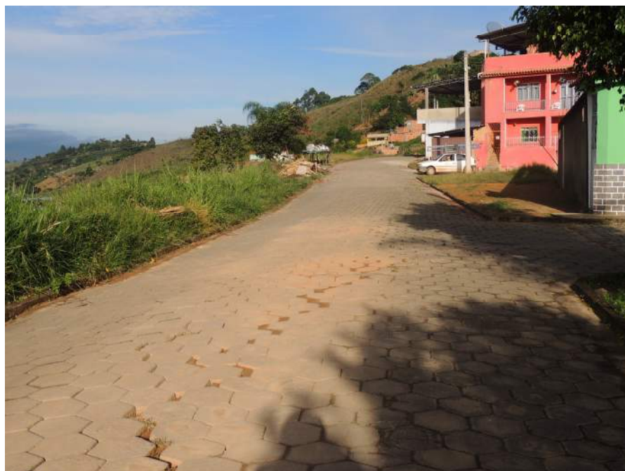
Foto 22 – Vista a partir da Rua a montante do setor com danos no pavimento provavelmente relacionados a rede de água/esgoto.
