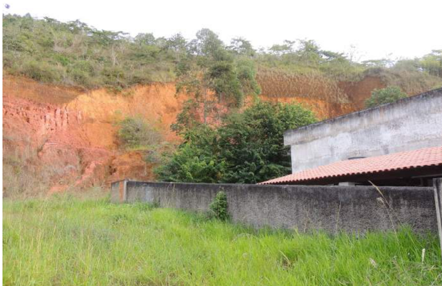
Foto 9 – Foto de parte da base da encosta com deslizamento já deflagrada nos fundos da edificação.
