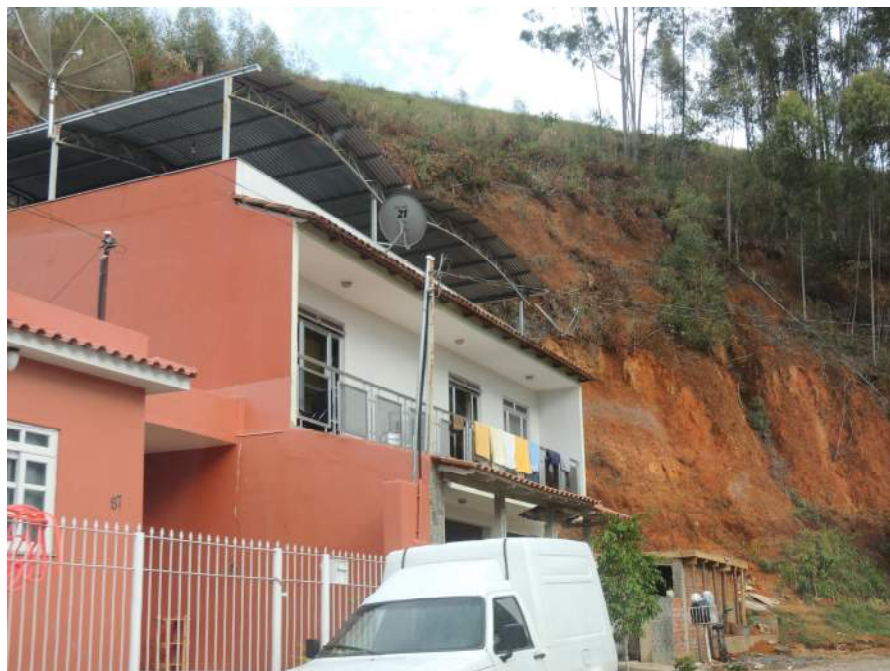
Foto 26 – Indícios de instabilidade ao longo da encosta que compõem o setor.
