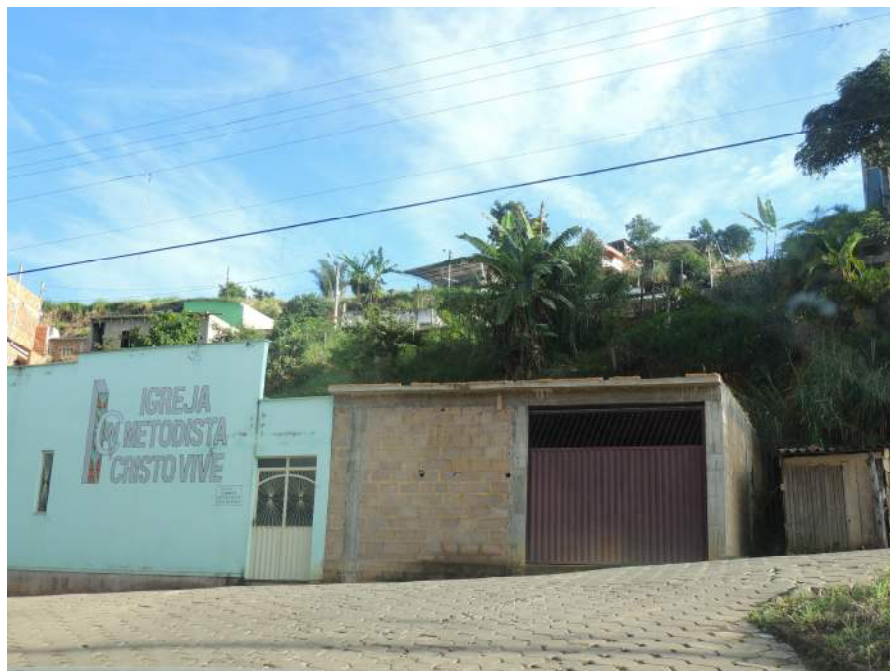
Foto 21 – Vista a partir da base do setor com ocupação a partir da geração de taludes de corte verticais com alturas superiores a 6,0m.
