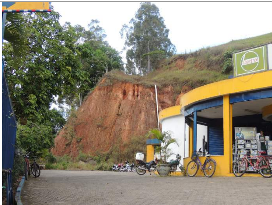
Foto 25 – Indícios de instabilidade em parte da encosta que compõem o setor.
