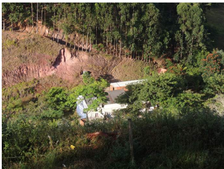
Foto 17 – Tombamento de solo com ocorrência pontual.
