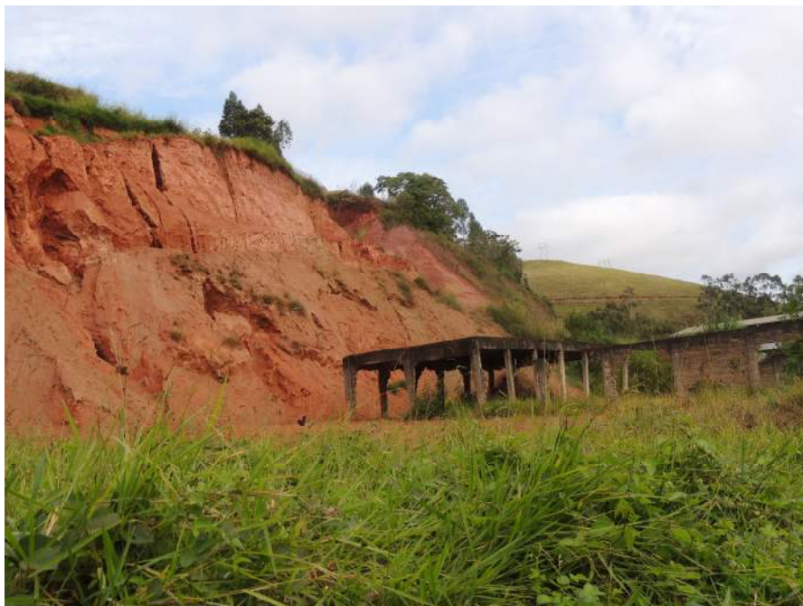
Foto 31 - Vista parcial do setor de risco. Detalhe para a altura dos taludes de corte, inclinação acentuada dos mesmos e movimentos de massa.
