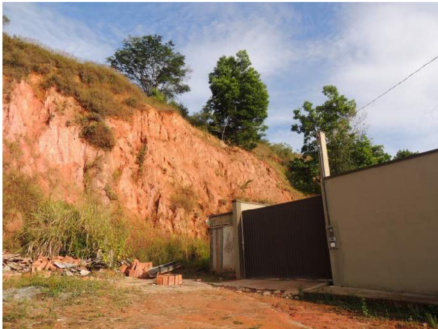
Foto 13 - Vista a partir da base do setor com detalhe para os indícios de instabilidade ao longo da encosta.
