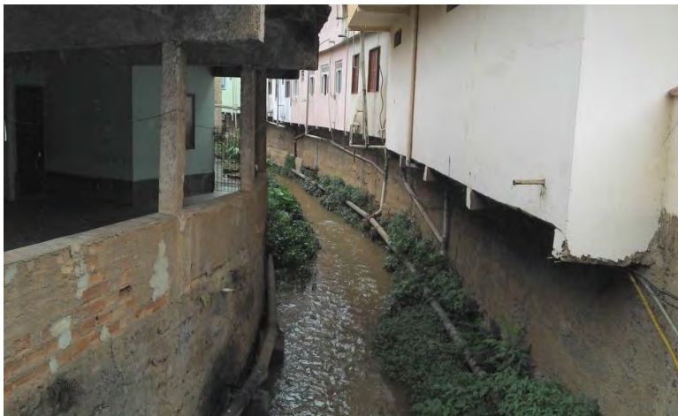
Figura 4-15: Trecho canalizado do Valão São Pedro assoreado.
