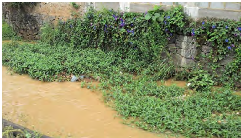
Figura 4-12: Seção de escoamento do Valão São Lourenço reduzida pelo assoreamento do curso d'água.
