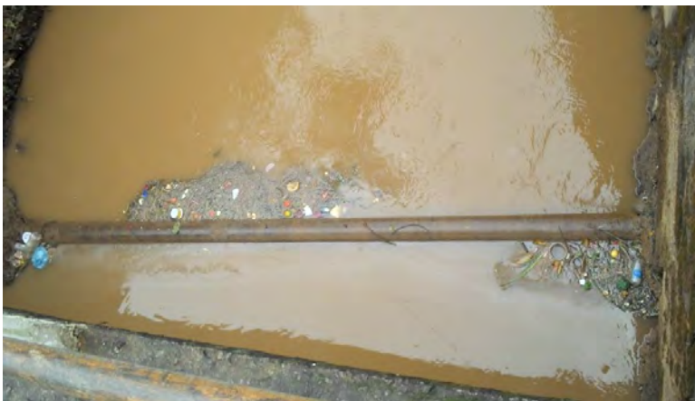
Figura 4-18: Tubulação de esgoto atravessando o canal do Rio Timbuí em cota inadequada.
