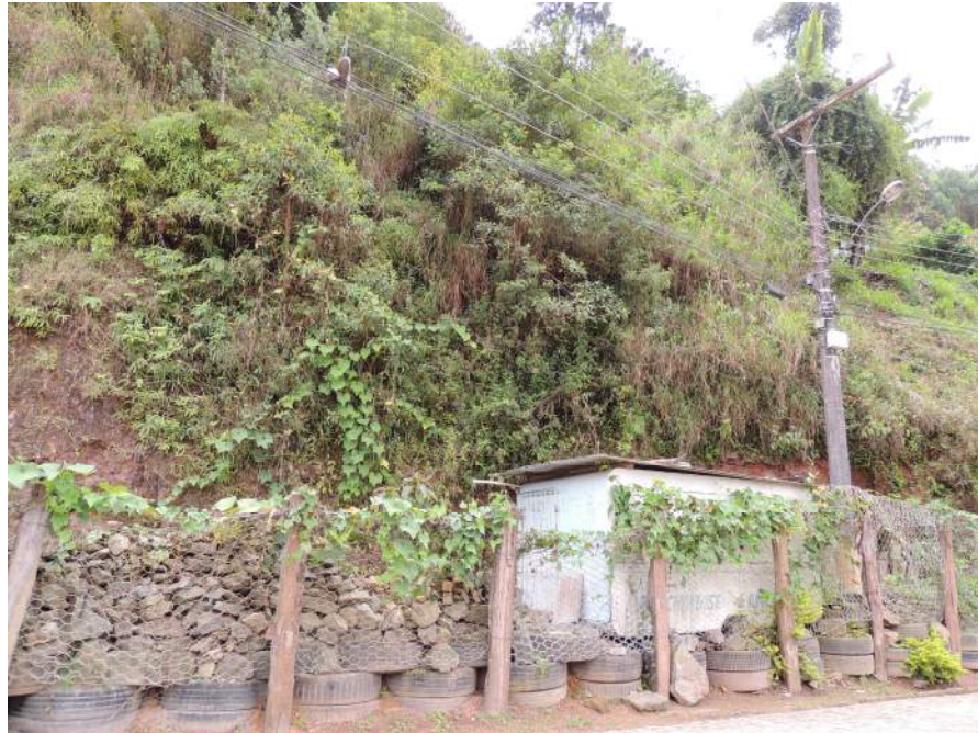
Foto 15 – Domicílio de baixo padrão construtivo e talude vertical.
