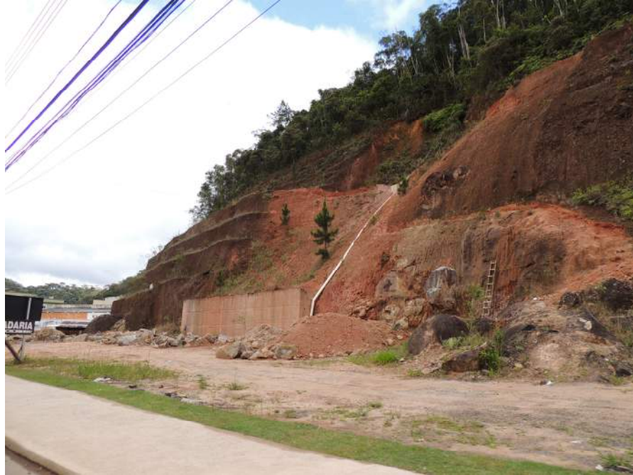
Foto 36 – Cicatrizes de escorregamento de grande porte ocorrido no local.
