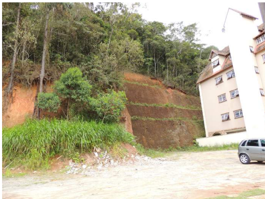
Foto 34 – Talude com altura superior a 10,0m com inícios de instabilidade.
