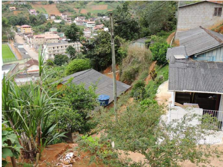
Foto 9 – Talude de corte instável no centro talvegue.
