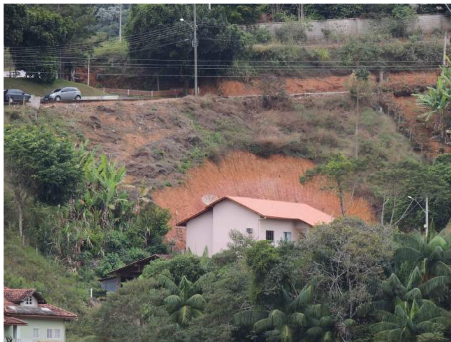
Foto 19 – Talude de corte subvertical e com altura superior a 10,0m.
