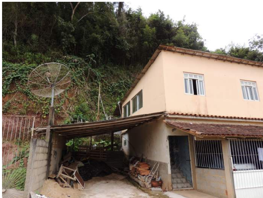
Foto 16 – Talude de corte não estabilizado.
