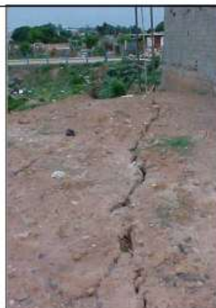
Trincas no terreno
