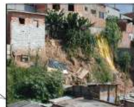
Obra de contenção do talude paralisada, necessitando a continuidade da obra Favela Pedra sobre Pedra
