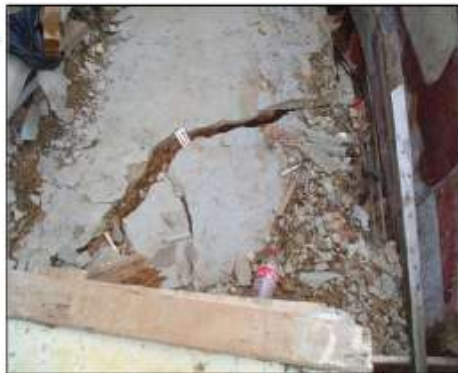
Trincas no terreno
