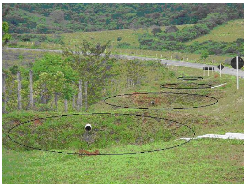
Figura 3-2: Bacias de contenção instaladas às margens de rodovia pavimentada.
