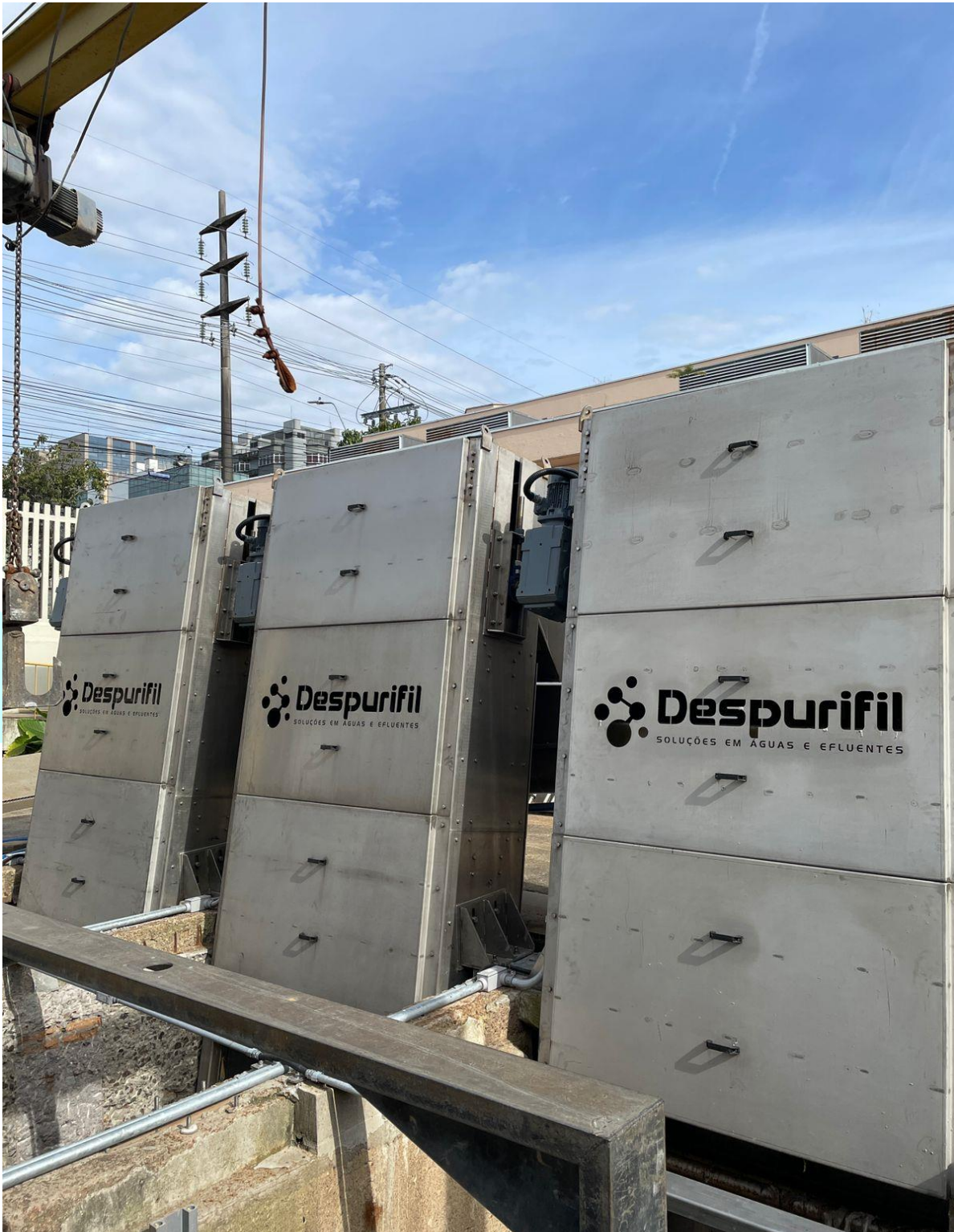
Grade Mecanizada tipo Multirastelos instaladas no DMAE PORTO ALEGRE
