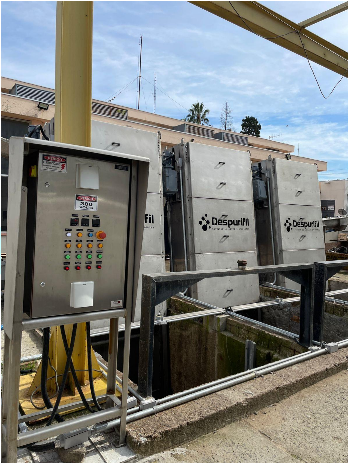
Grade Mecanizada tipo Multirastelos instaladas no DMAE PORTO ALEGRE
