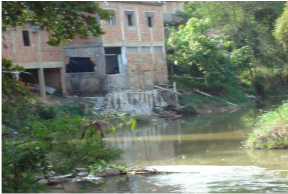
Figura 6-5: Construção de casas sobre as margens do Córrego Belo Monte.
