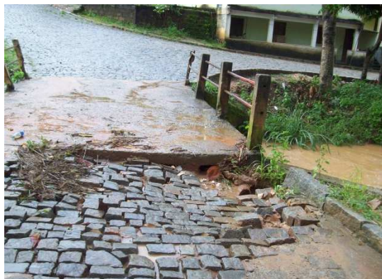
Figura 6-23: Março/2009. Ponte sobre o Córrego Santa Marta. Imagem pós-inundação.
